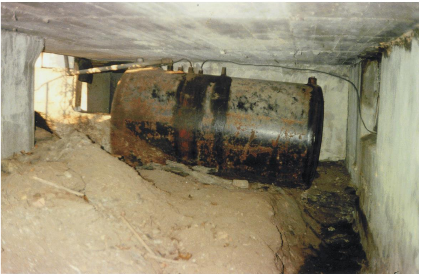
Fra rivningen av Uldals Handelskole på Lagårdsveien i forbindelse med bygging av nytt politihus. Foto: John Johnsen, Feiervesenet, ca. 1995.
